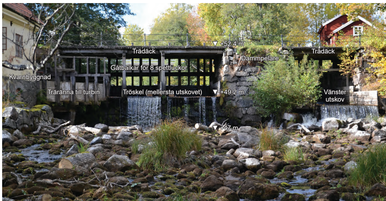
Figur 7. Mellersta och vänstra utskovet (till vänster respektive höger i bild) betraktat från nedströms dammen. Under lägre flöden blir huvudfårans botten smalare. Norconsult, oktober 2016.
