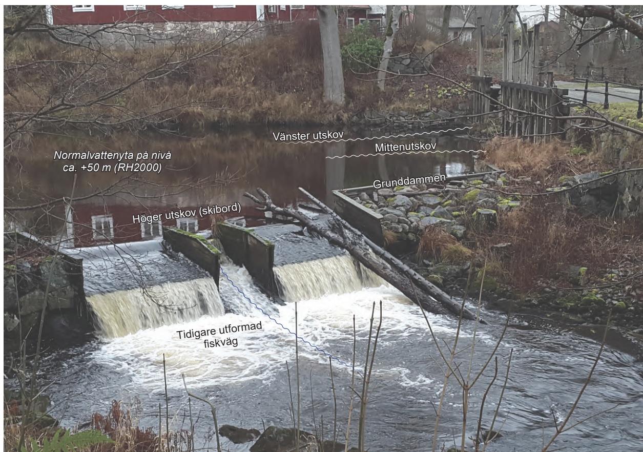
Figur 4. Högra utskovet (grunddammen) består av ett skibord i tre delar och utformades på 1970-talet. Den mittersta sektionen är planerad som fiskväg. Norconsult, 2014.
