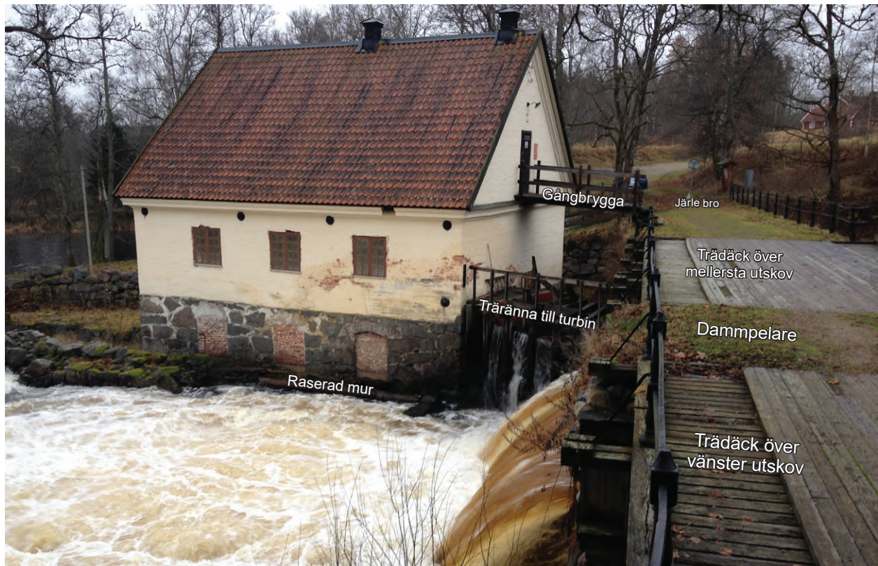
Figur 6. Kvarnbyggnaden betraktat från trädäcket över vänstra utskovet. Under gångbryggan mellan murverksdammen och byggnadens övervåning ses intagsrännan till turbinen och kraftstation. Delar av murverket intill kvarnbyggnadens grund har rasat, vilket medfört inträngning av vatten till källarplanet. Norconsult, november 2014.
