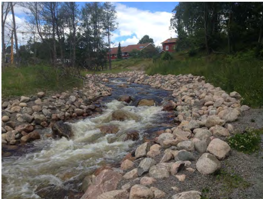
Figur 19. Omlöp Hedefors kraftverk. Norconsult 2014.
